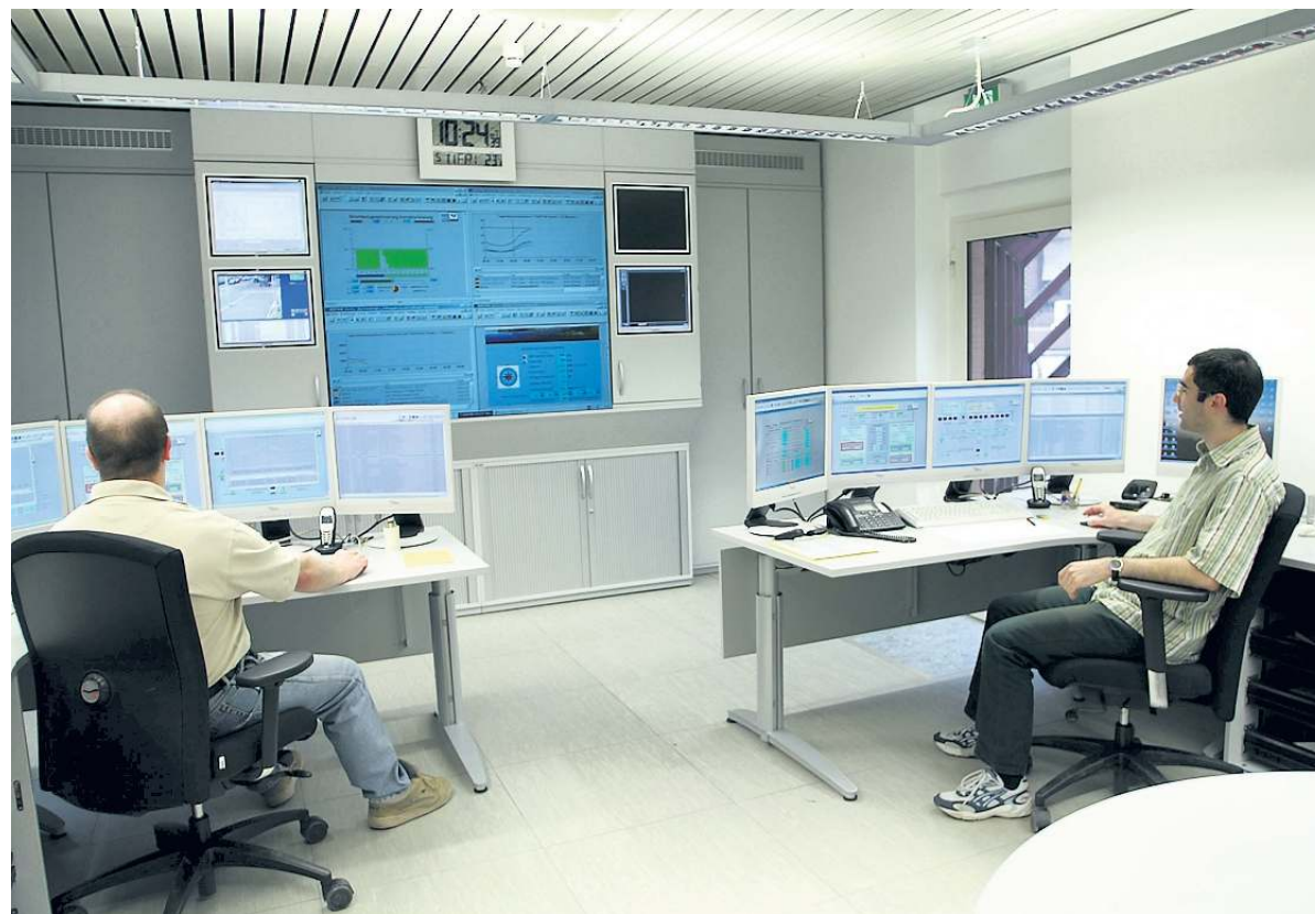
Die Netzleitwarte der Stadtwerke Weinheim. Hier laufen auch bei einem Stromausfall alle Fäden zusammen – so auch am Dienstagabend, als in großen Teilen Weinheims die Lichter ausgingen.
